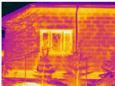
Рис. 1. Потери тепла через кладочные швы, выполненные на традиционном растворе
